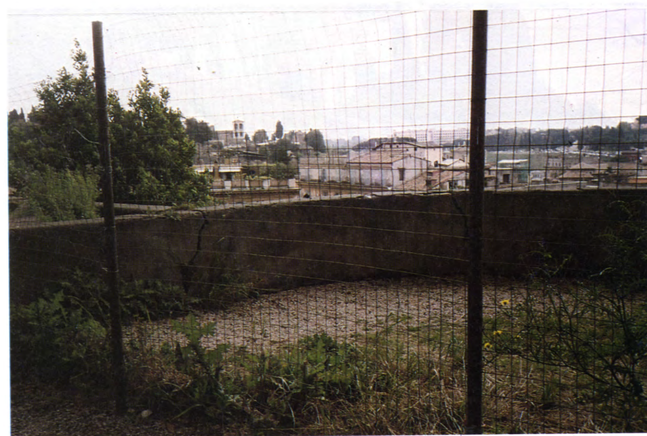
Fig. 7 - Particolare delle lesioni a carico delle opere di sostegno della Rupe Tarpea (parte sommitale). (foto: M. Pecci).
