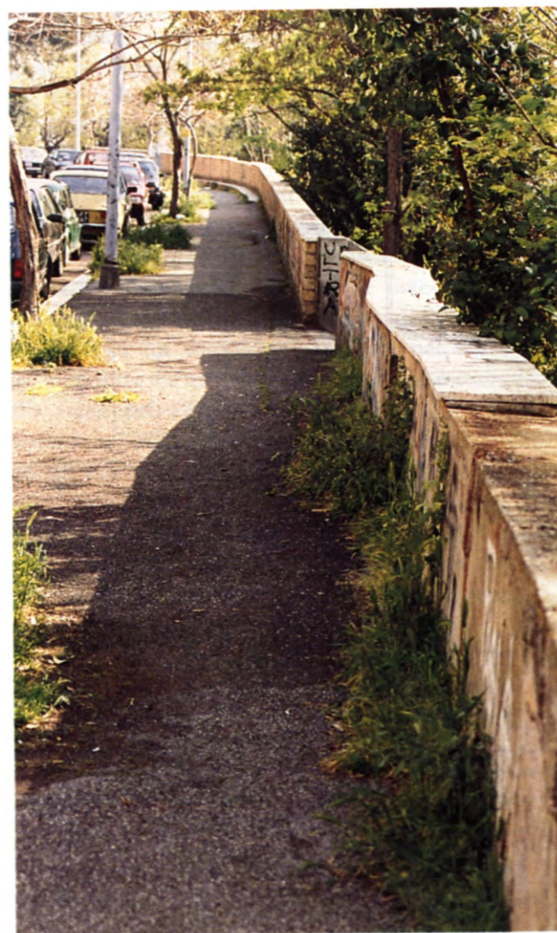
Fig. 2 - Muretto danneggiato dai movimenti in atto sul versante sottostante Via A. Saffi; è visibile l'imbocco della scaletta pericolante di Via U. Bassi. (foto: M. Amanti).
