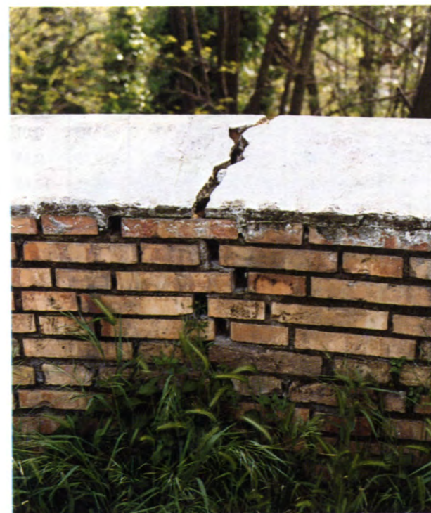
Fig. 3 - Particolare delle fessure e crepe nel muretto di Via A. Saffi, all'altezza dell'incrocio con Via delle mura gianicolensi. (foto: M. Amanti).
